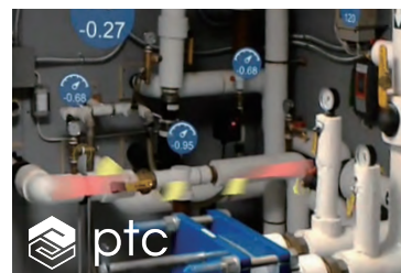
図4. ARとIoT技術を使用した保守点検 IoTの技術を使用して、センサー情報を表示。ARの技術を使用して色で配管内の物質を識別表示。アニメーションで流れを表現。(画像提供:PTCジャパン)
